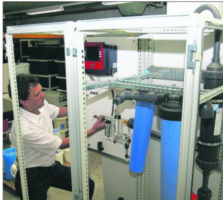
Wolfgang Lindner, Technischer Leiter der Salt of Life Technologie GmbH aus Leubsdorf justiert die Mess- und Regeltechnik der Starksoblebadeanlage.
