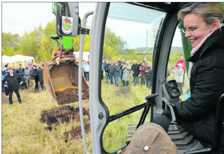
Die CDU-Bundestagsabgeordnete Veronika Bellmann hat gestern einen ersten Baggerhub für die Ortsumgehung Freiberg ausgeführt. Mit dem symbolischen Baustart an der Frauensteiner Straße sollte die Dringlichkeit des 68-Millionen-Euro-Projekts unterstrichen werden. —FOTO: ECKARDT MILDNER
